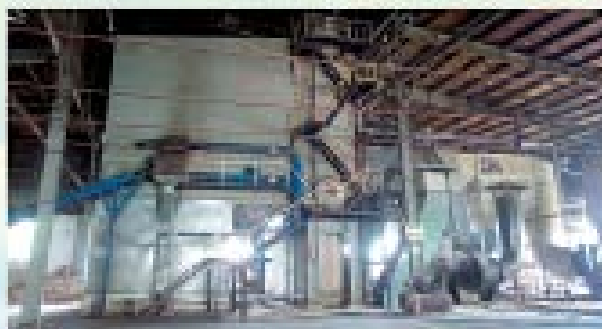
Hệ thống xử lý của Tín Thành Group với công suất 10 MW tại bãi rác tại tỉnh T, cung cấp năng lượng cho công nghiệp và khu vực dân cư
