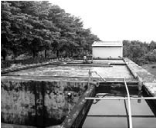
▲ Hệ thống XLNT với công suất 600 m 3 /ngày, đêm của Công ty
