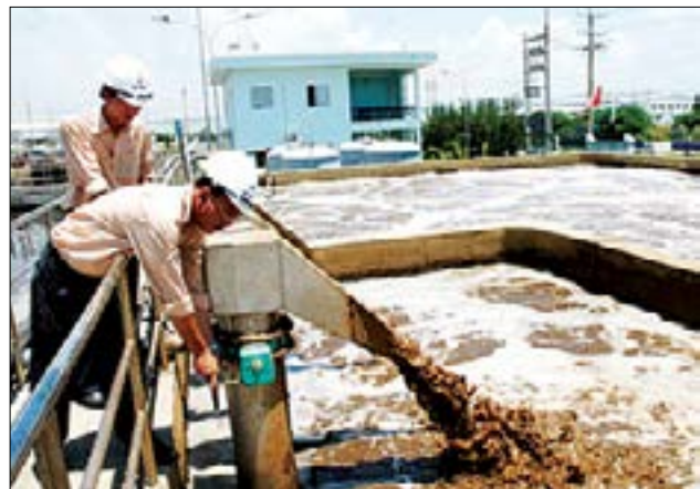
▲ Cơ sở có lưu lượng nước thải từ 1.000 m 3 /ngày đêm trở lên phải có công tơ điện tử đo điện độ lập của hệ thống xử lý nước thải
