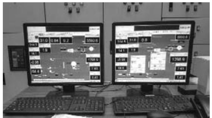
▲ Trạm phát điện 3MWh từ nhiệt thừa được Công ty triển khai hiệu quả tiết kiệm điện và giảm phát thải KNK
