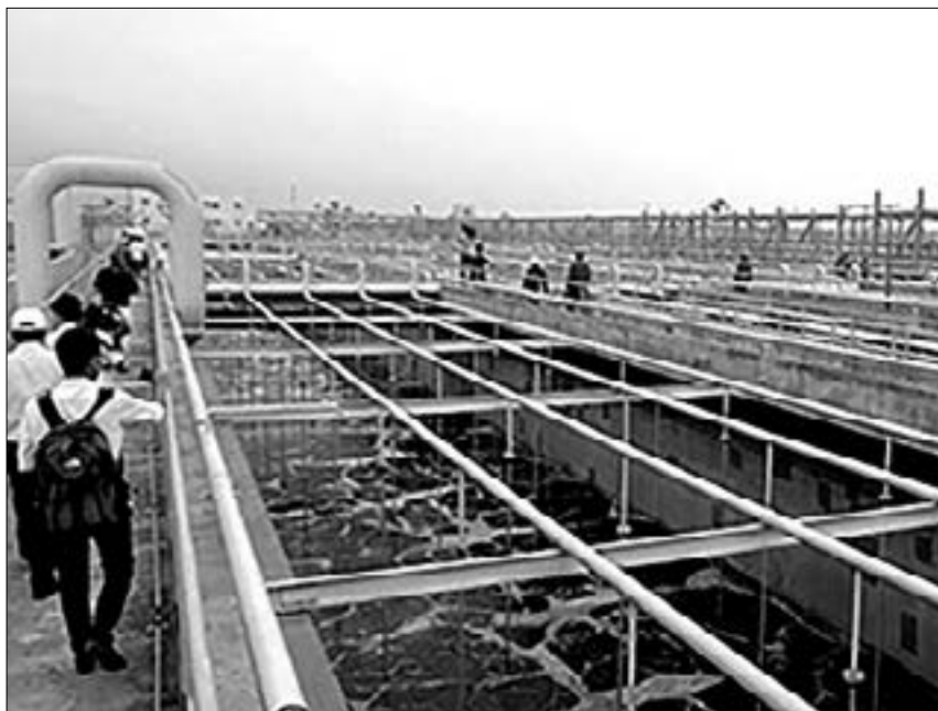
▲ Hệ thống xử lý nước thải của FHS
